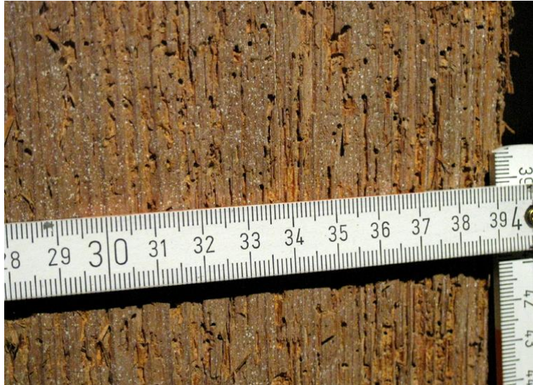
Abbildung 1 Nicht mehr aktiver Anobienbefall am Gebälk einer denkmalgeschützten Scheune aus dem 19. Jahrhundert
