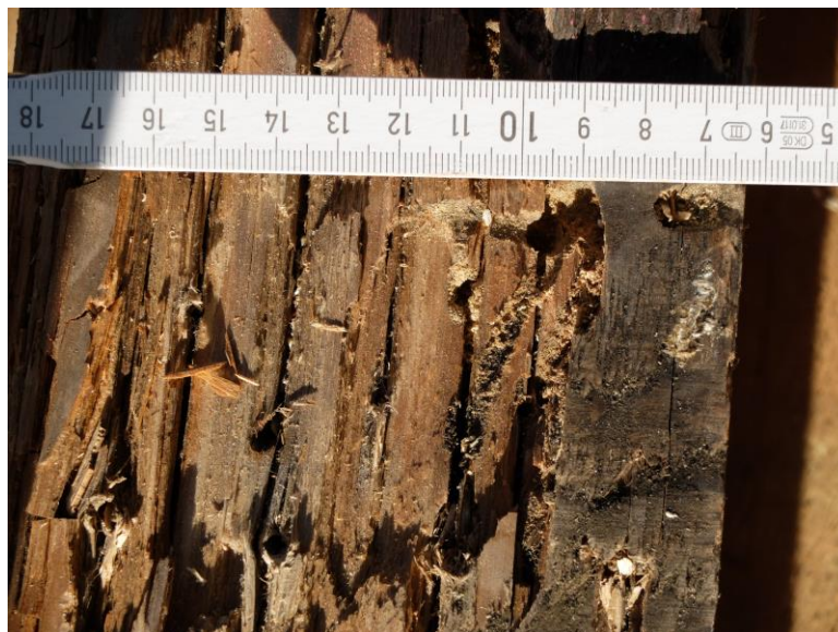
Abbildung 2 Befall eines neuwertigen, stark durchfeuchteten Deckenbalkens (Flachdachkonstruktion mit Sparrenzwischendämmung BJ 2008) durch diverse Insektengattungen
